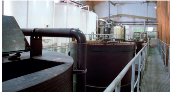
PE sewage plant
